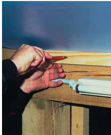
il. 09, 10 » Połączenie ściana – sufit zasłonięte listwą
